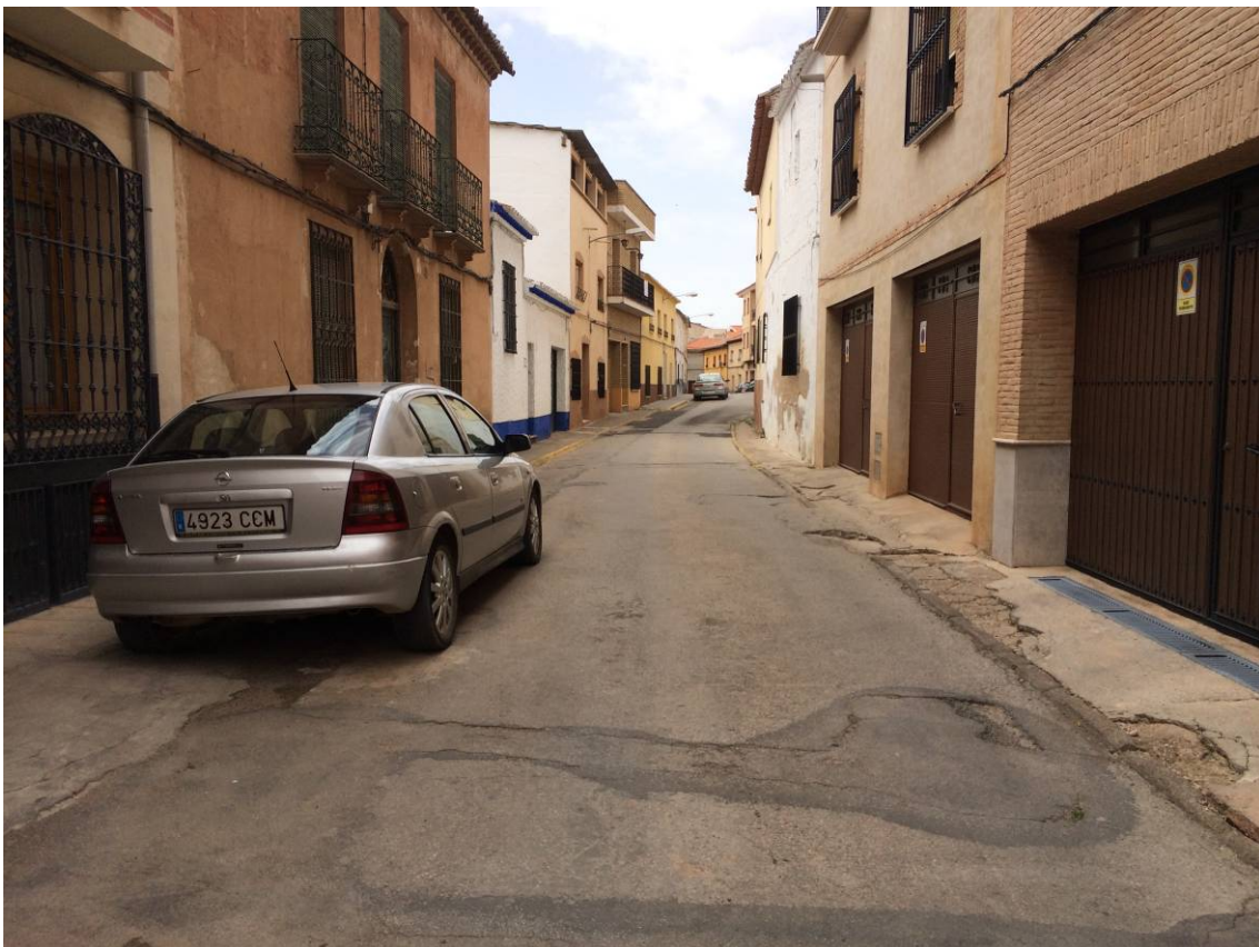
Foto 6.- Calle Portezuelas. Acera no accesible y en mal estado
