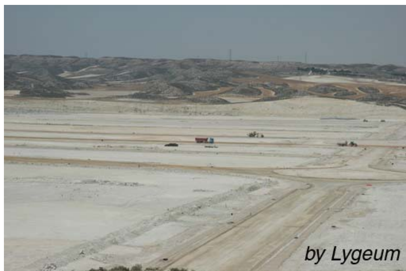
Un claro ejemplo de destrucción del suelo por obras públicas en Zaragoza
